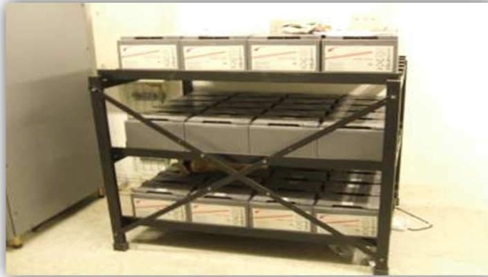
Figure IV.2: Les batteries de secours.
