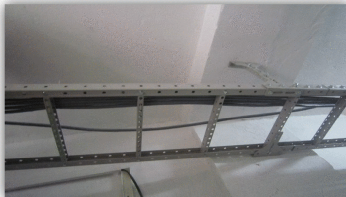
IV.3: Chemin de câbles.
