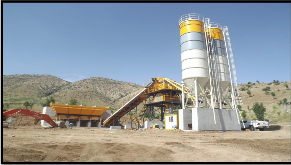
Figure I.6: Centrale à béton compacte
