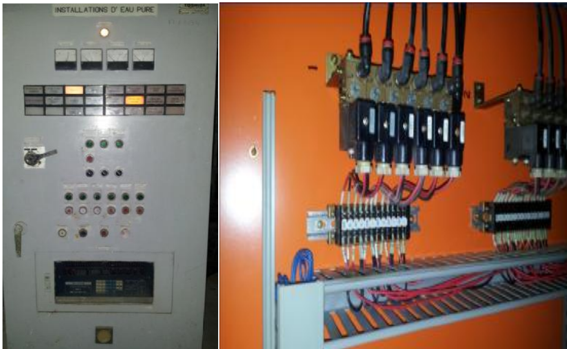
Figure I -18 : Armoire de commande.
