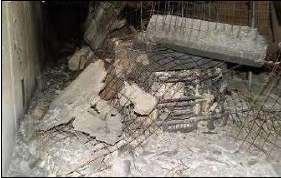
Figure II.1 : Section effondrée du faux plafond dans le tunnel du Gothard après l'incendie du 21 octobre 2001, thèse doctorat 2007 Annaba.
