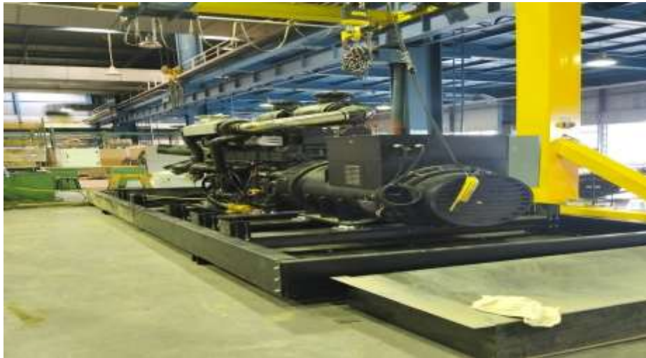
Figure N°12: Le groupe électrogène existant auto-diesel
