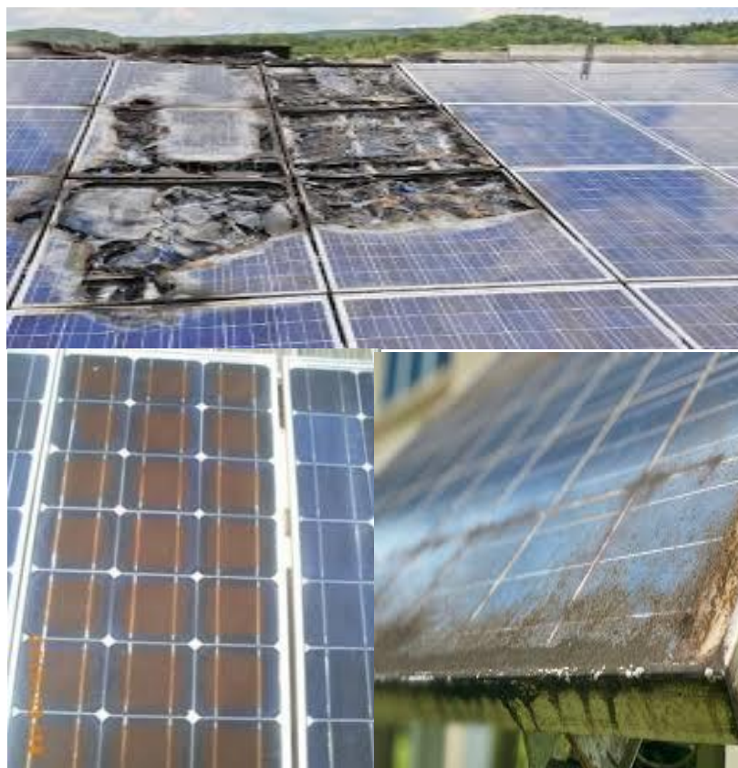
Figure I. 18 : module photovoltaïque dégradé [17]
