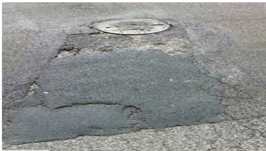
Figure II . 8: pelades dans les couches d'une chaussée.
