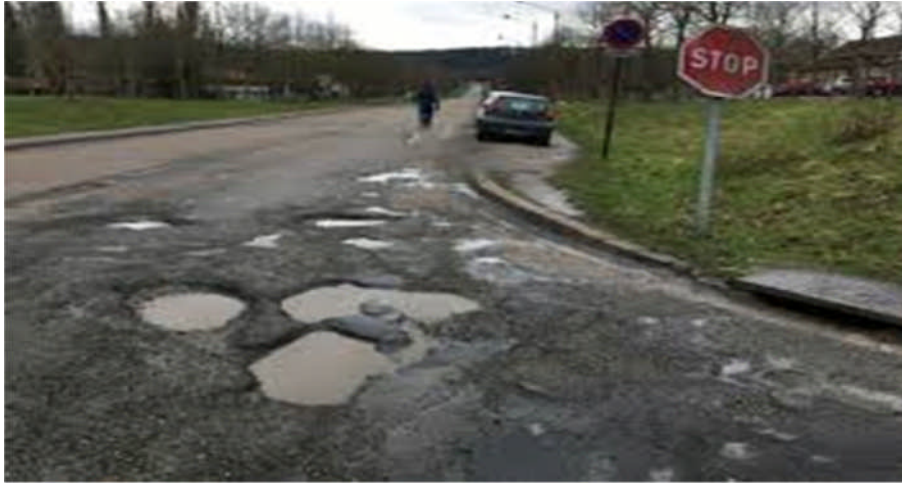
Figure II . 7: nids de poule dans les couches d'une chaussée
