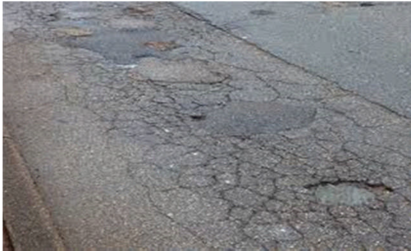
Figure II . 2: affaissement d'une chaussée
