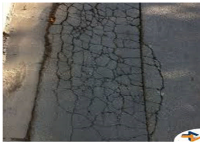
Figure II . 4: décohésion du sol de part et d'autre de la tranchée un faïençage revêtement
