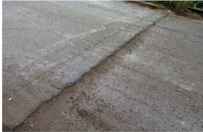
Figure II . 3: tassement d'une chaussée
