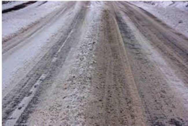
Figure II . 5: ornière dans les couches de chaussées
