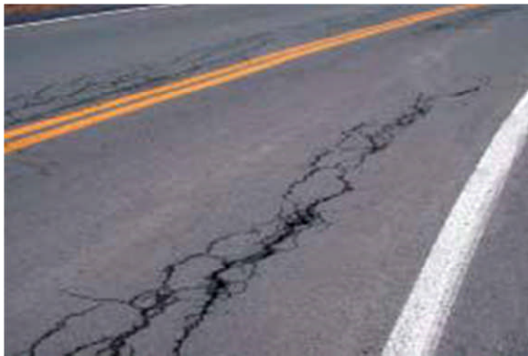
Figure II . 1: apparition des fissures longitudinales sur les routes
