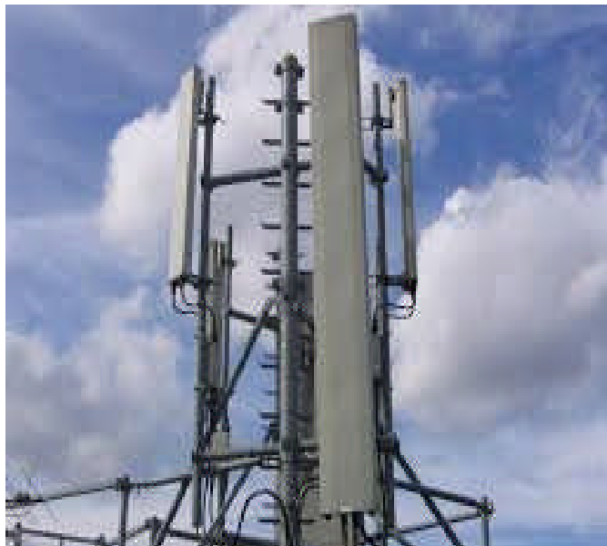
Figure III.3. Antennes panneaux et antennes perches
