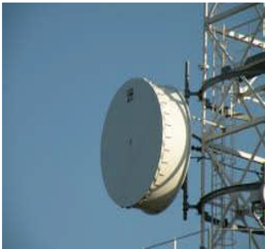
Figure III.7. Antenne d'un faisceau hertzien
