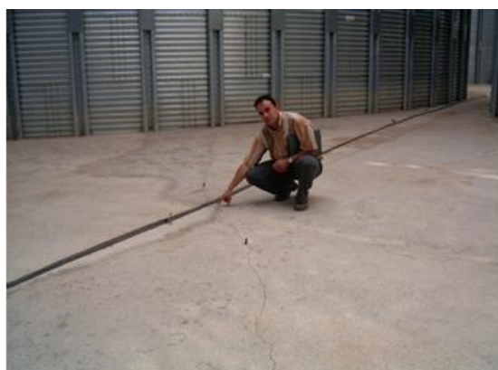
(a)-Fissures profondes dans le radier
