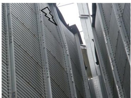
(c)-Déformation silos et flambage des raidisseurs
