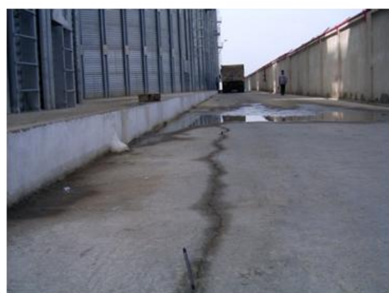
(a)-Fissuration et affaissement de la voirie
