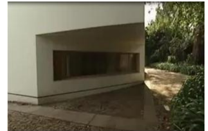
Fig 46 : RDC d'un bloc décalé à cause des racines d'un arbre
