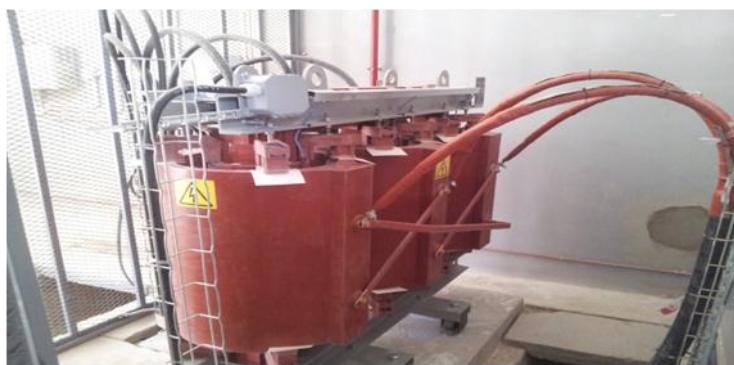
Figure III.12 : Transformateur auxiliaire MT/BT
