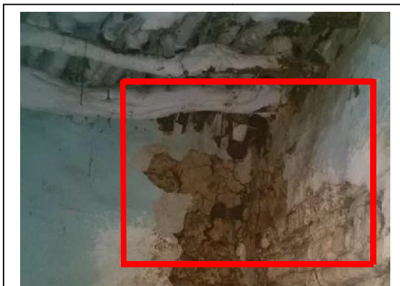
Photo 5-11 : dégradation de l'enduit en terre sur les pierres (sous l'effet de l'humidité). Sources : L'auteur le 17/07/2016
