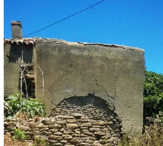
Photo 1-20 : Dégradation du bâti due au manque d'actions opérationnelles Source : photo prise par l'auteur le 16-05-2016
