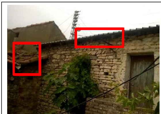
Photo 5-4 : Effondrement total et partiel de la toiture (sous l'effet du séisme) Source : l'auteur le 17/07/2016
