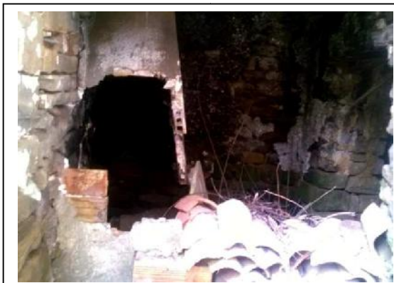
Photo 5-3 : Effondrement partiel du mur et de la cheminée (sous l'effet du séisme) Source : l'auteur le 17/07/2016
