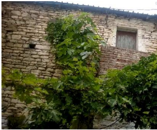
Photo5-15 : Envahissement de la maçonnerie par les plantes. Sources : L'auteur le 17/07/2016
