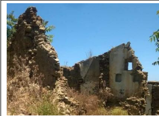
Photo 5-5 : Effondrement total et partiel de la toiture (sous l'effet du séisme) Source : l'auteur le 17/07/2016
