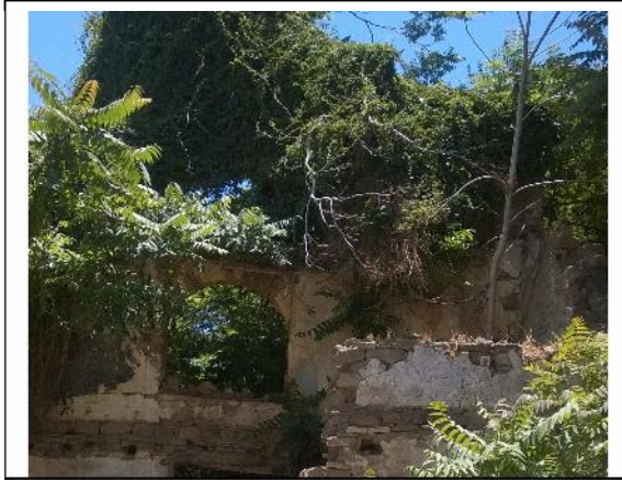
Photo1-15 : Dégradation du bâti vernaculaire de Dellys suite au séisme de 2003 Source : photo prise par l'auteur le 16-05-2016
