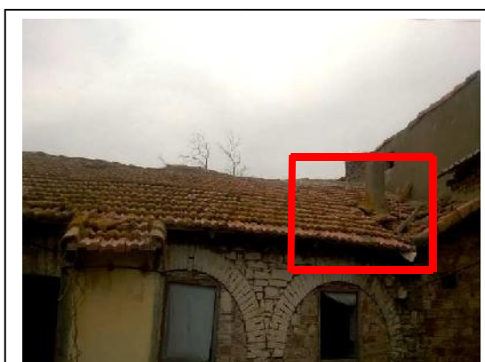
Photo 5-2 : Soulèvement et cassure des tuiles (sous l'effet du vent) Source : l'auteur le 17/07/2016
