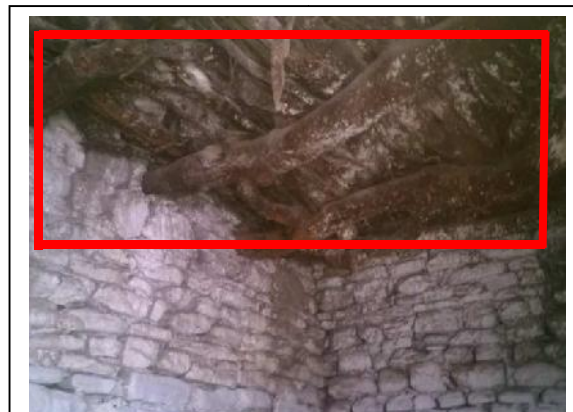
Photo 5-12 : Pourrissement du plancher (sous l'effet de l'humidité). Sources : L'auteur le 17/07/2016
