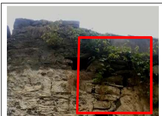
Photo 5-1 : Décollement des pierres (sous l'effet du vent) Source : l'auteur le 17/07/2016
