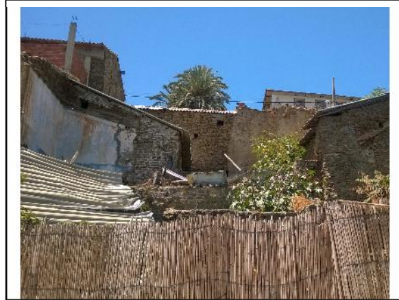
Photo1-16: Dégradation du bâti vernaculaire de Dellys suite au séisme de 2003 Source: photo prise par l'auteur le 16-05-2016
