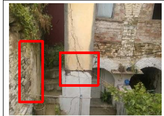
Photo 5-6 : Fissures horizontales et verticales (sous l'effet du tassement) Source : l'auteur le 17/07/2016
