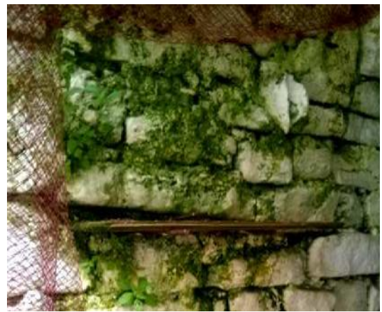
Photo 5-16: Envahissement de la maçonnerie par les lichens et les mousses. Sources : L'auteur le 17/07/2016
