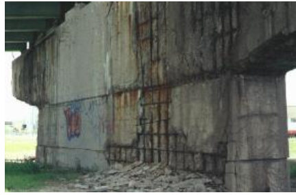
Figure I-2 : Agression du béton par activité des chlorures.
