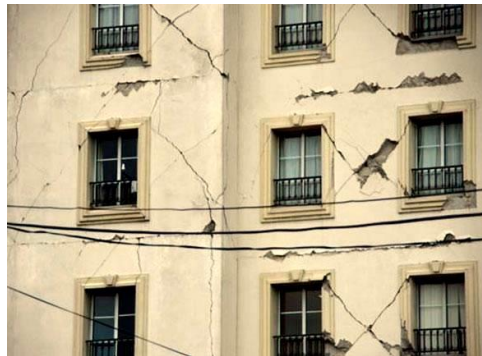
Figure I-5: Désordres dus au séisme.
