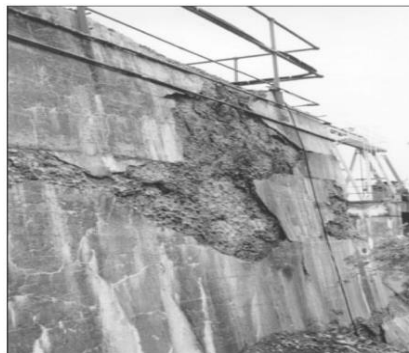
Figure I-6 : Exemple de dommages causés par le gel-dégel.
