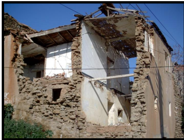
Figure 11: Maison en ruine. Source : (PPSMVSS) DE LA VIEILLE VILLE DE DELLYS
