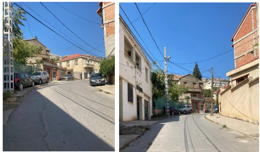
Figure 94: Vue sur l'état des voies piétonnes sur la rue MIMOUNE. Source : auteurs
