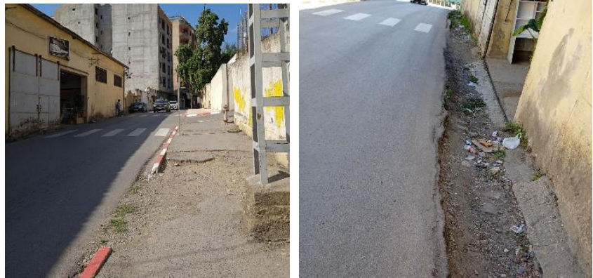
Figure 92 : : Vues sur l'état des voies piétonnes de la rue KESRI. Source : auteurs
