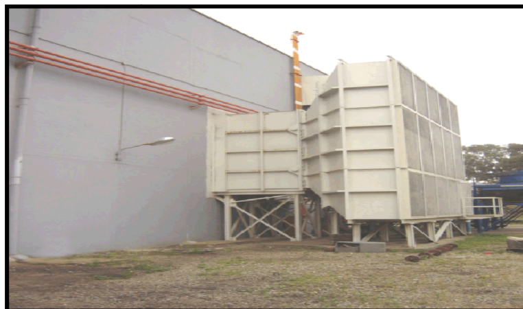
Figure I.7 : Système d'admission d'aire de la centrale de Bab Ezzouar
