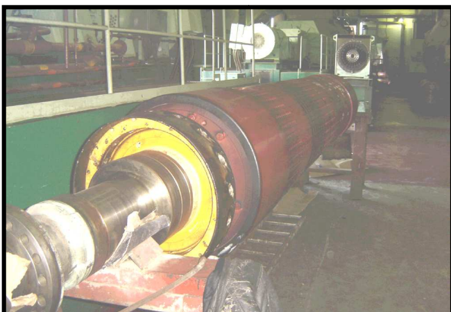
Figure I.5 : Rotor à pôle lisse d'un alternateur de la centrale de Bab Ezzouar
