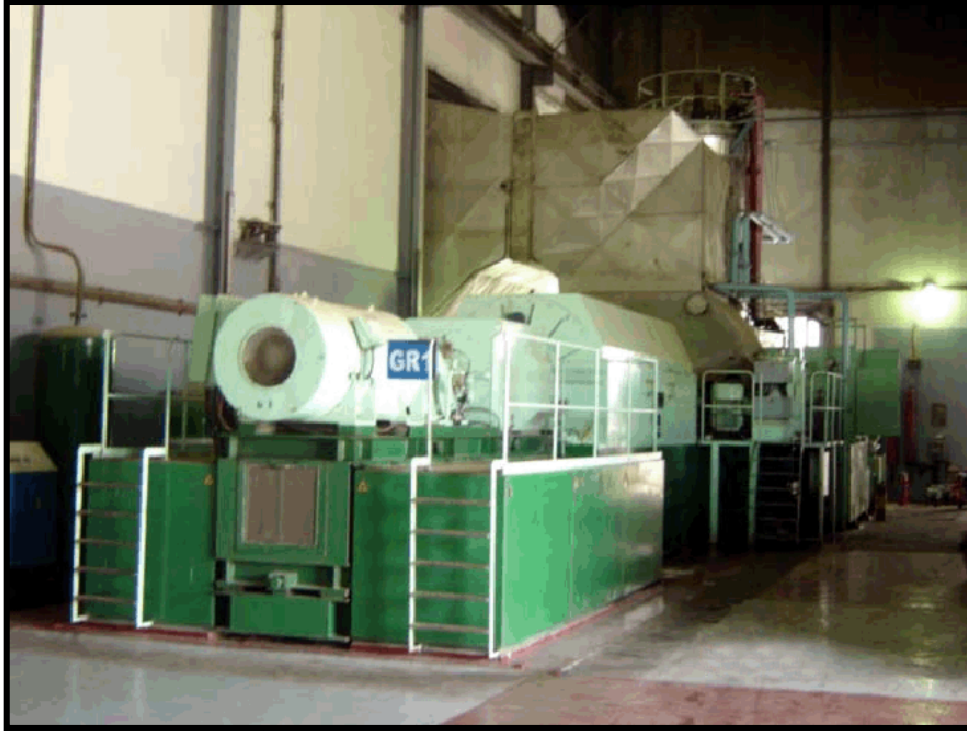
Figure I.3 : Groupe turbo-alternateur de la centrale de Bab Ezzouar
