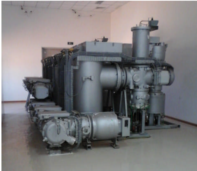
Fig II- 3: le poste GIS au niveau du champ de Zarzaïtine.
