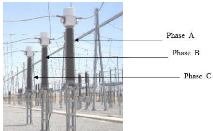
Fig I- 13: transformateur de courant dans un poste électrique.
