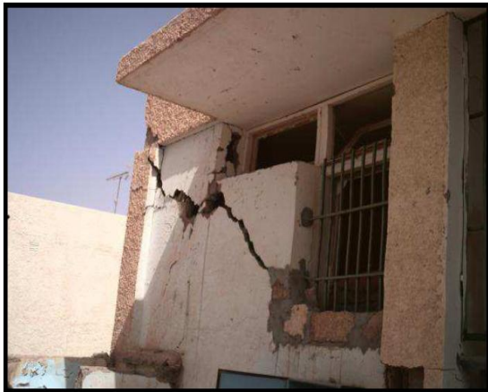
Figure II.1 : Fissure sur les murs (Zenkhril, 2010)
