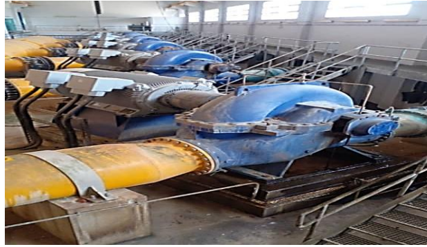
Figure.III.4. Station de pompage SEAAL.
