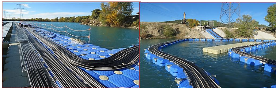
Figure.II.10 : Système de câblage [21].
