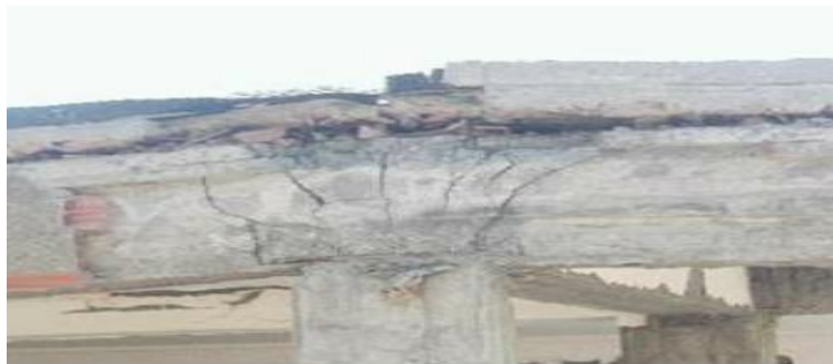
Figure I. 21. Rupture par cisaillement d'un nœud en béton armé (Séisme de Boumerdes, Algérie, 2003)
