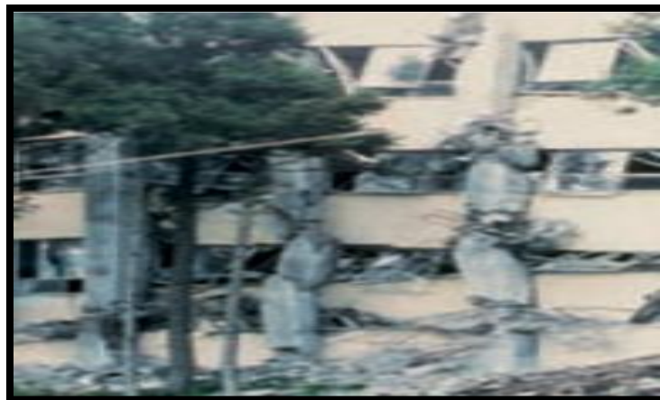
Figure. I. 9 Effondrements de bâtiment dû au non-respect du principe « Poteaux forts - poutres faibles ».La résistance ultime des poutres-allèges en béton armé était supérieure à celle des poteaux. En outre, on peut observer l'effet de poteau court (séisme de Tokachi-Oki, Japon 1968 et d'Izmit, Turquie 1999)
