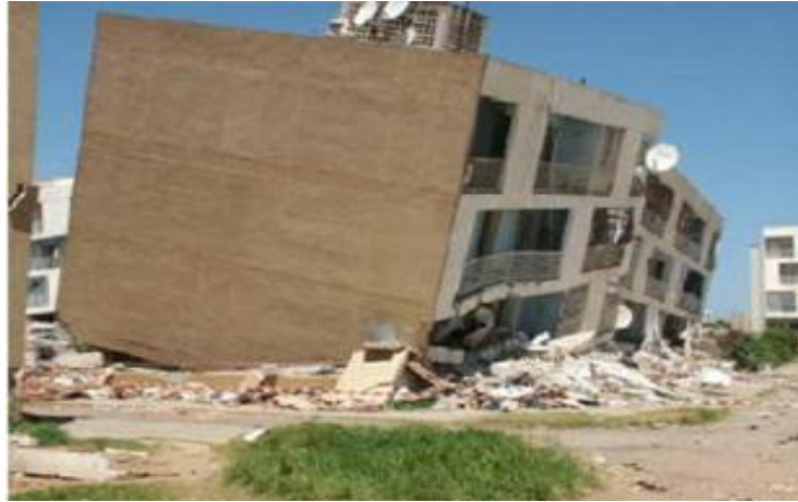
Figure I.23. Effondrement complet d'une construction au niveau 1 (Boumerdes, Algérie 2003)
