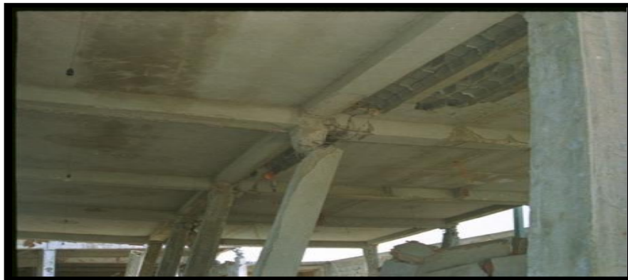
Figure. I. 11. Rupture du nœud selon la petite inertie du poteau (Séisme de Boumerdes 2003)
