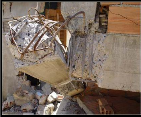
Figure.I.14: Effondrement à cause de l'absence d'armatures transversales dans les nœuds et dans la zone critique du poteau (Séisme de Boumerdes 2003)
