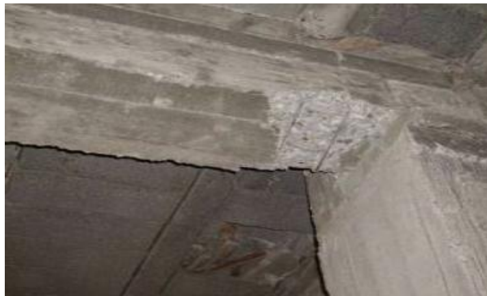
Figure. I. 20. Fissuration par cisaillement dans la poutre (Séisme de Boumerdes, Algérie, 2003) [11]
