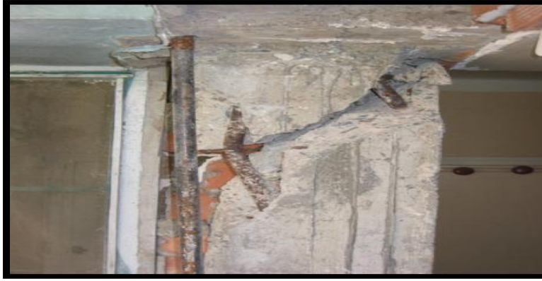
Figure I.6 la rupture du nœud des poteaux _ poutres avec flambement local des aciers longitudinaux par manque de ferrailage des aciers transversaux
