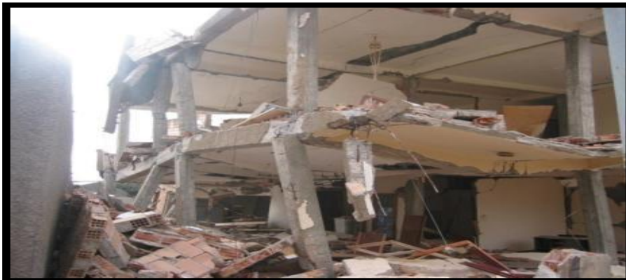
Figure I. 12. Rotules plus accentuées aux extrémités des poteaux du premier niveau à la limite de l'effondrement (Séisme de Boumerdes 2003)
