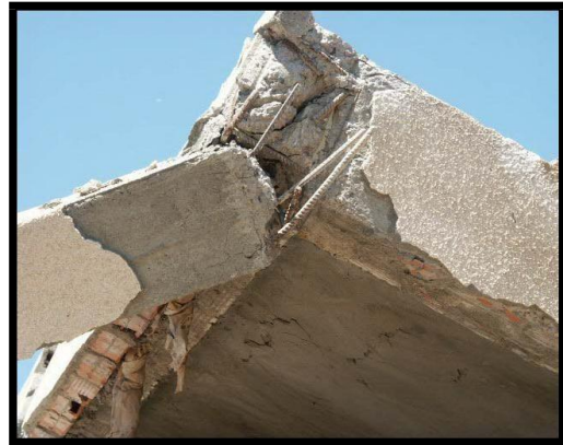
Figure. I. 13 La Rupture du nœud poteaux – poutres avec flambement local des aciers longitudinaux par manque de frettage des aciers transversaux. (Séisme de Boumerdes 2003)
