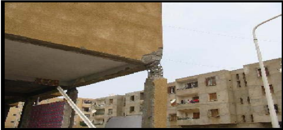
Figure I. 10 La section des poteaux étant souvent équivalente à celle des poutres la Plastification des nœuds se produit en tête ou en pied de poteau (séisme de Boumerdes 2003)
