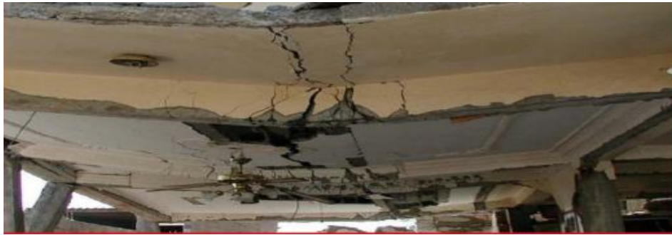
Figure. I. 18 Fissuration par flexion dans la travée des poutres
