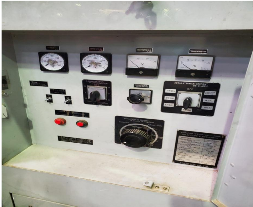
Figure III.8. Poste de contrôle du banc d'Essai[47].
