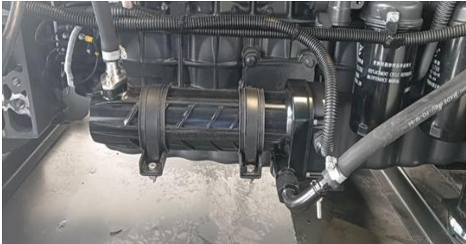
Figure III.7. Pompe de pris chauffage de groupe électrogène [47].
