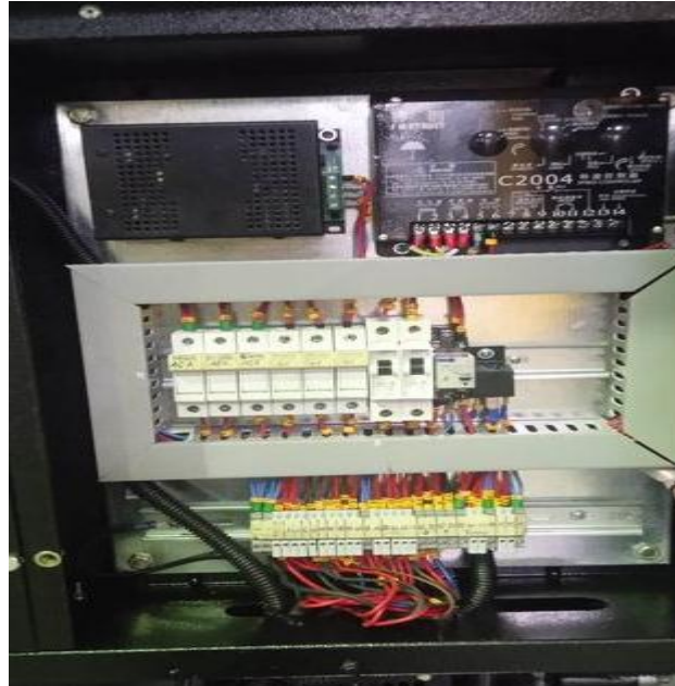
Figure II.4. Exemple d'une armoire électrique pour un groupe électrogène [25]
