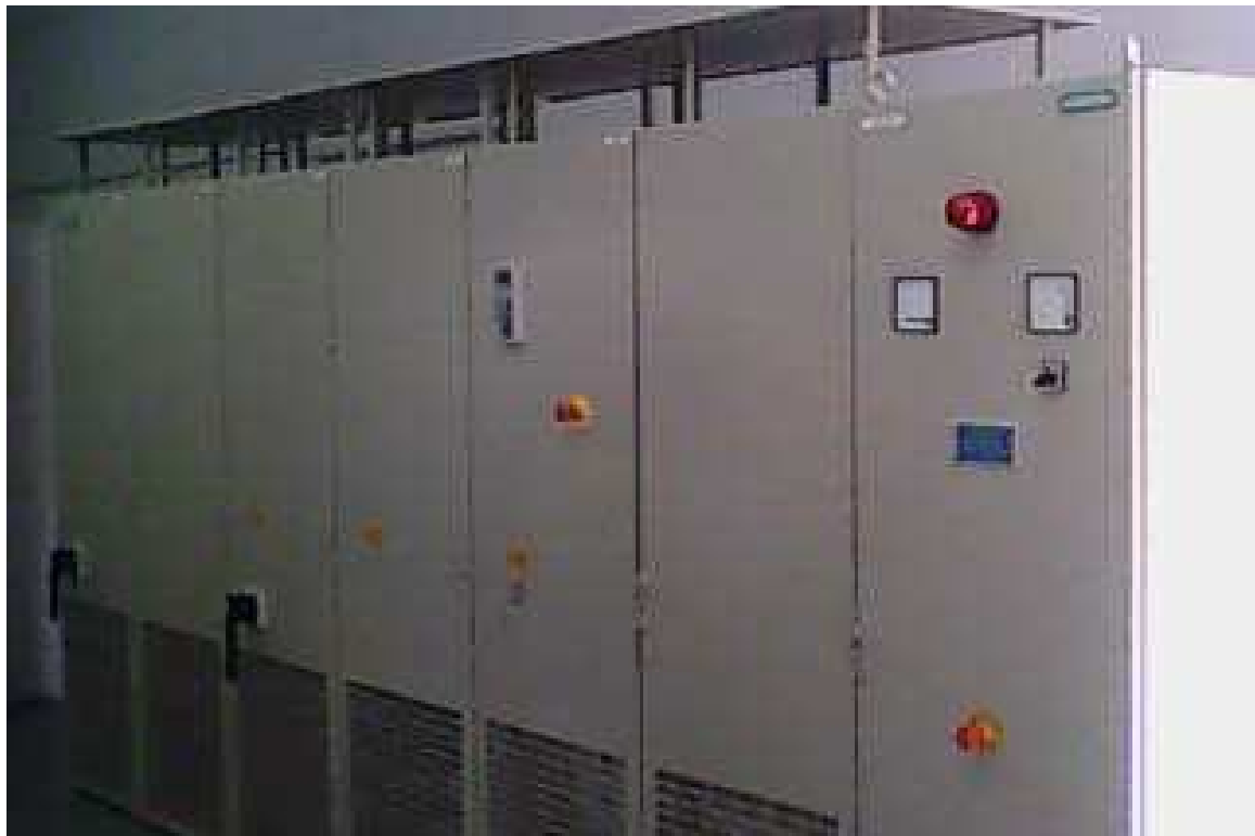
Cellule de protection du transformateur 1600 kVA
