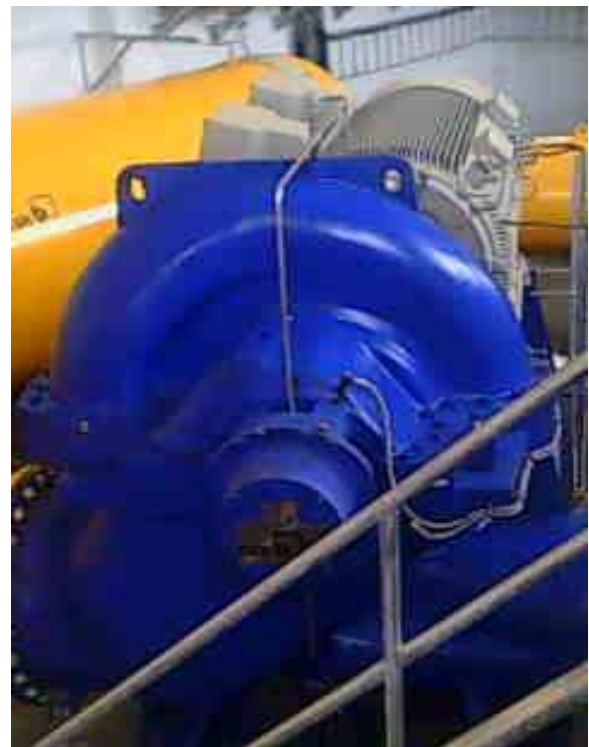
Vue de face du Moteur N°5
