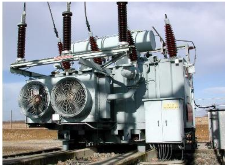
Figure I.19 : Transformateur de puissance à refroidissement forcé.
