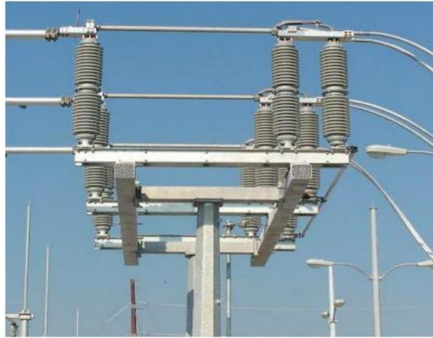
Figure I.21 : Sectionneur à haute tension à isolement dans l'air.
