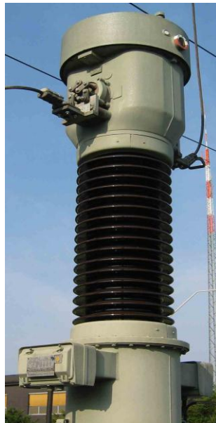
Figure I.18 : Transformateur de courant.
