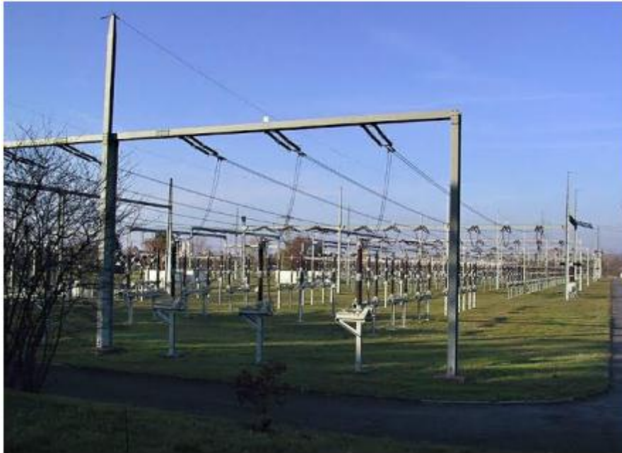
Figure I.22 : Jeu de barres d'un poste 400kV.
