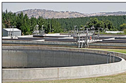
Figure I.11 : Usine de traitement des eaux usées en Australie. Source: https://fr.wikipedia.org .
