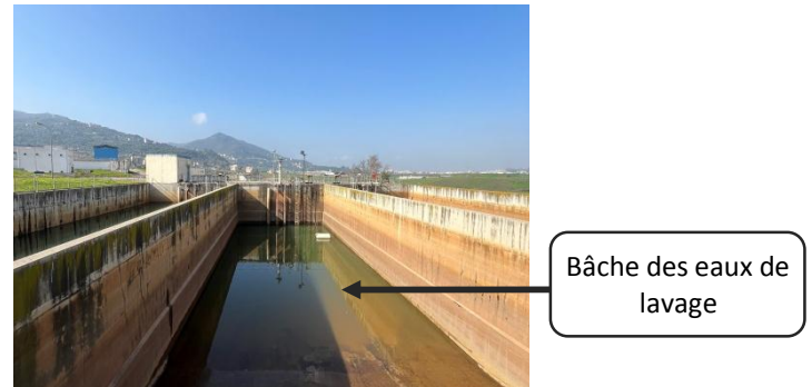
Figure I-17 : Bâche des eaux de lavage
