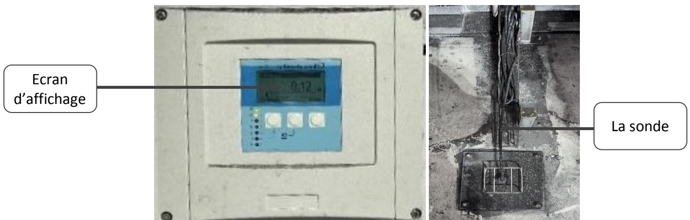
Figure II-17 : Transmetteur de niveau et La sonde
