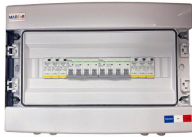
Figure II-9: Coffret contrôle sécurité dépoussiérage
