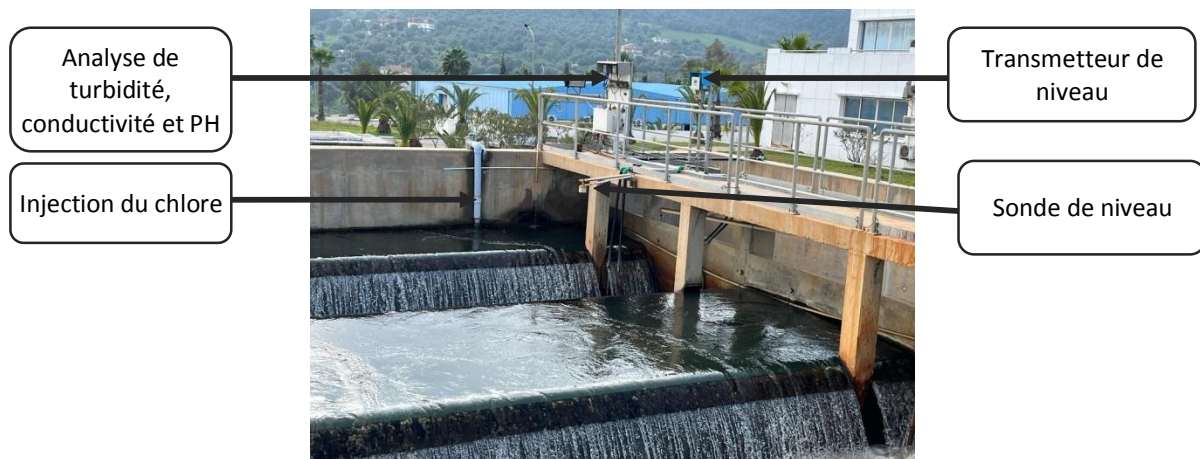
Figure I-6: Chambre de Dissipation
