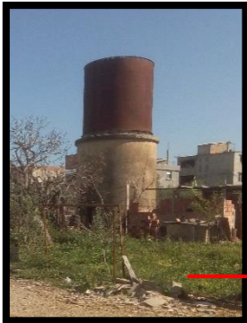
Figure 57 : Réservoir Abandonné Source : Auteurs.
