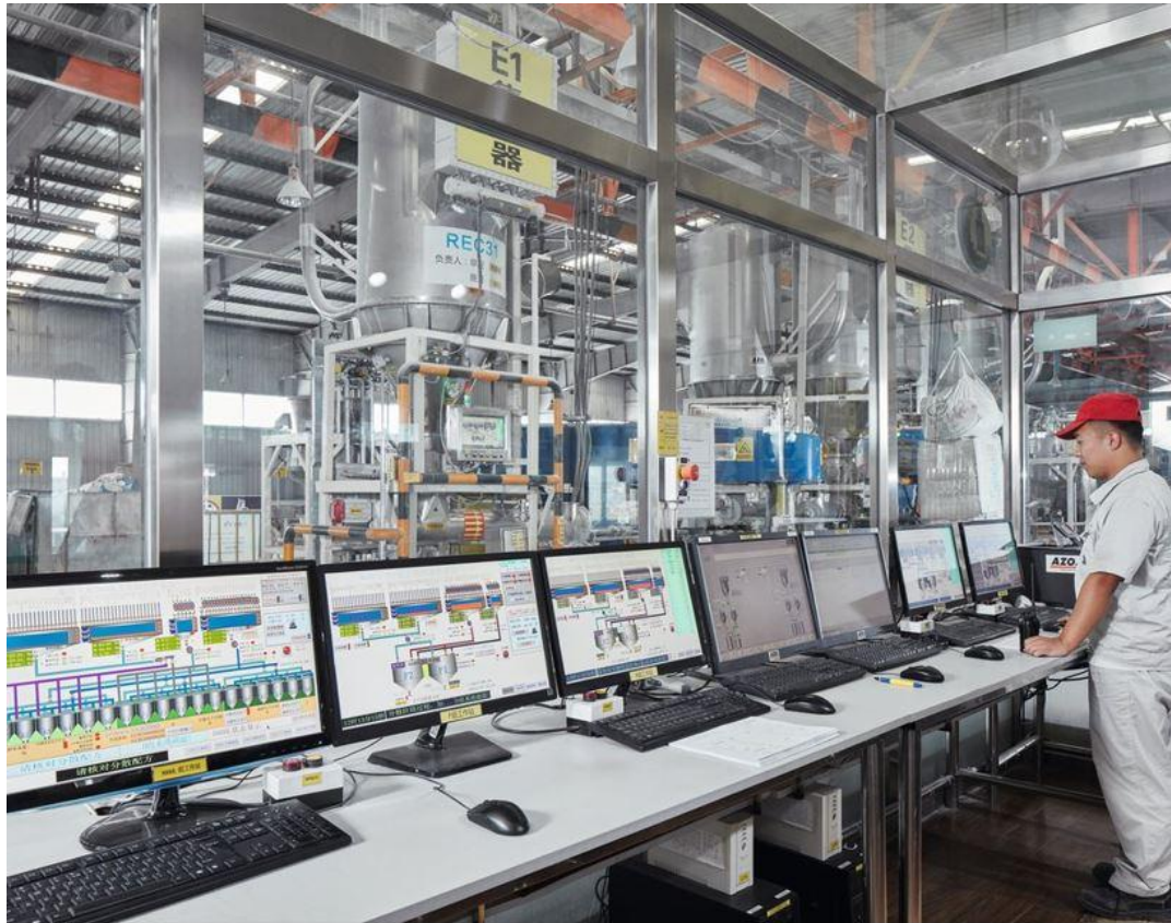
Figure 4.25 : Poste de pilotage d'une salle de supervision.
