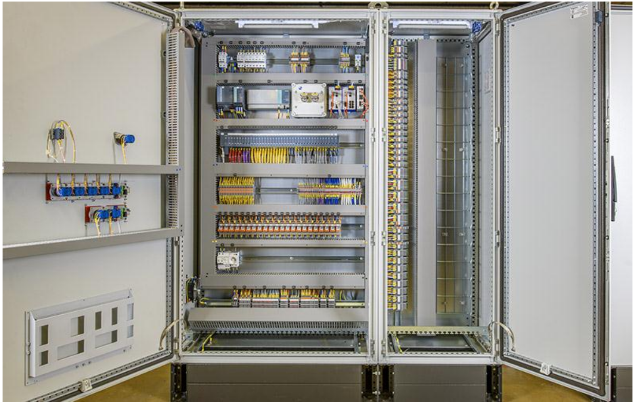
Figure 1.2 : Armoire de commande.
