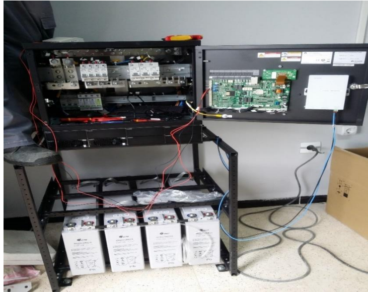
Figure III.17 : Installation de redresseur de tension.
