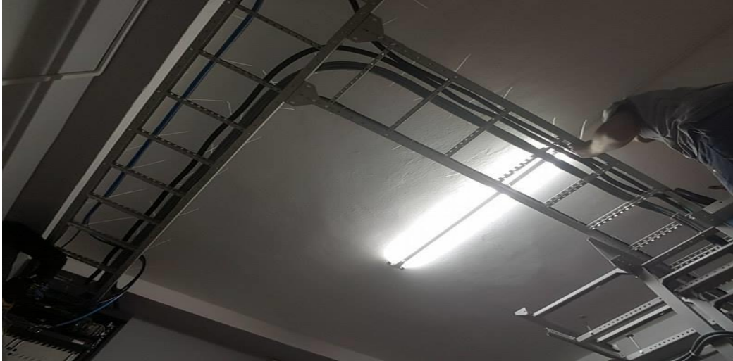
Figure III.15 : Le chemin de câble.
