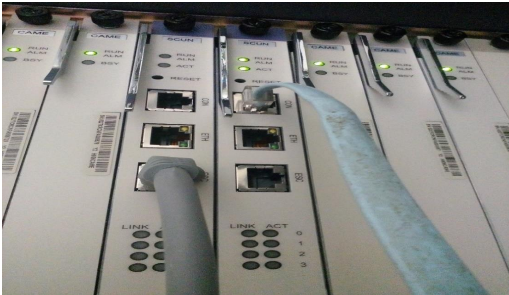
Figure III.21 : Le port console et le port GE dans le MSAN.
