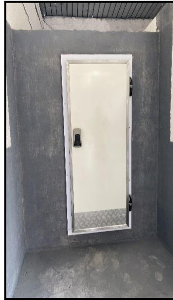
Figure 40 : La chambre froide utilisée pour le stockage et la conservation avant incinération.
