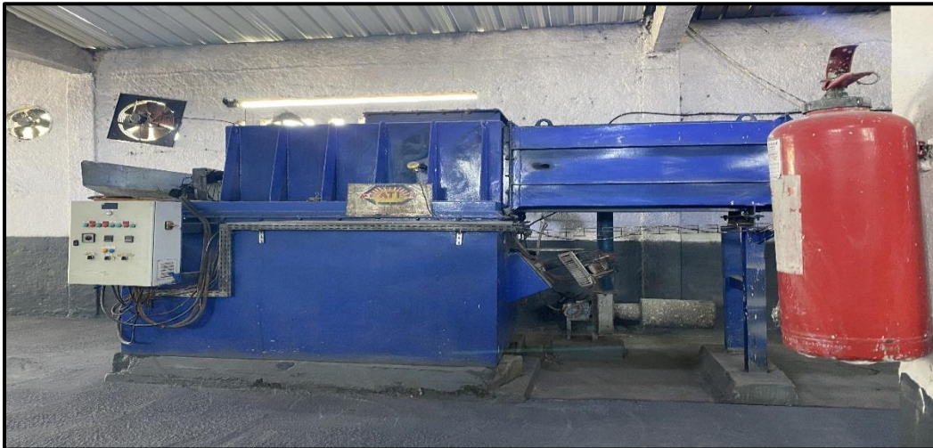
Figure 41 : Incinérateur des déchets pharmaceutiques
