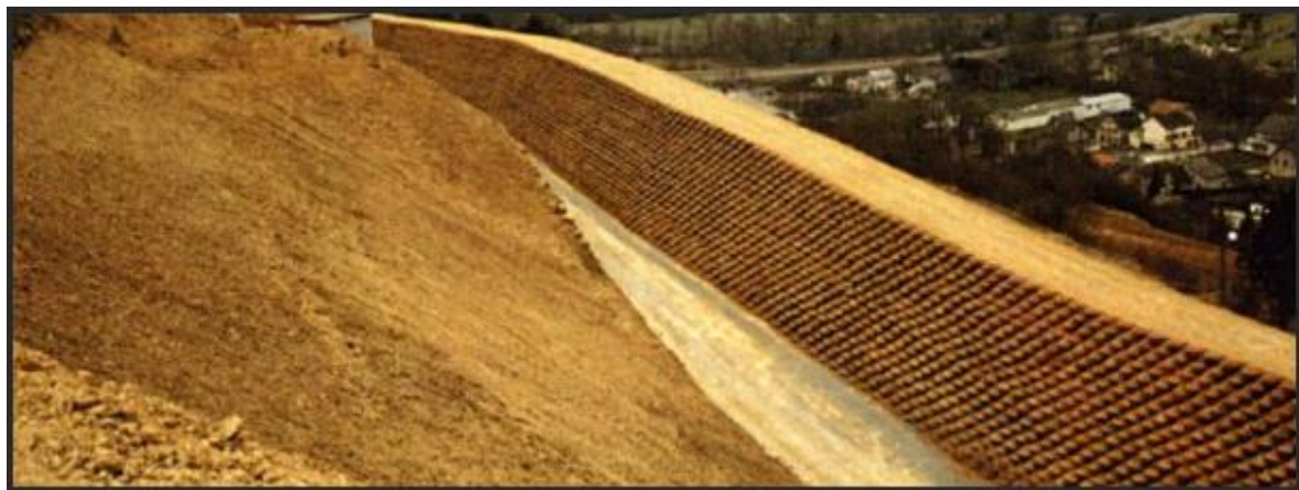
Figure II-7 : Merlon protecteur contre les chutes de blocs [4]
