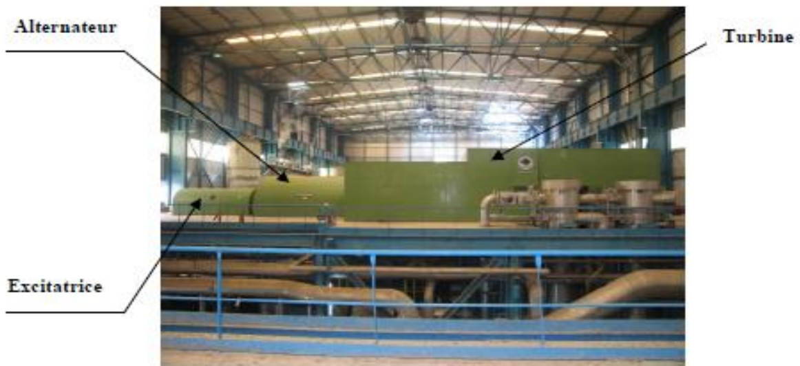
Figure I.4 : Photo réelle du Groupe turbo-alternateur de la centrale
