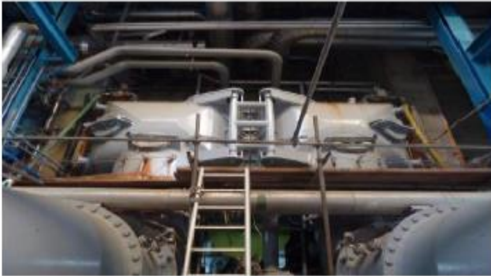
Figure I.3 : Vue générale de condenseur de la centrale
