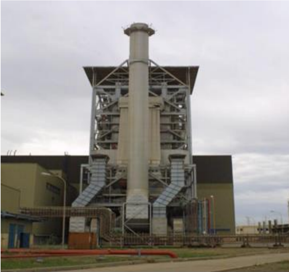
Figure I.2 : LA Chaudière de la centrale de Cap Djinet
