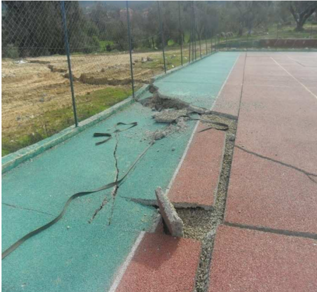
Affaissement d'un stade
