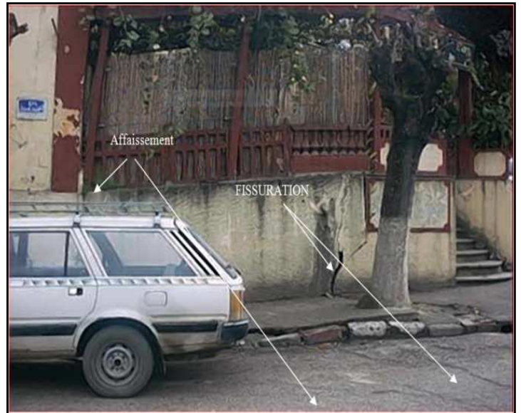
Affaissement de la chaussée et d'une vieille bâtisse [11]
