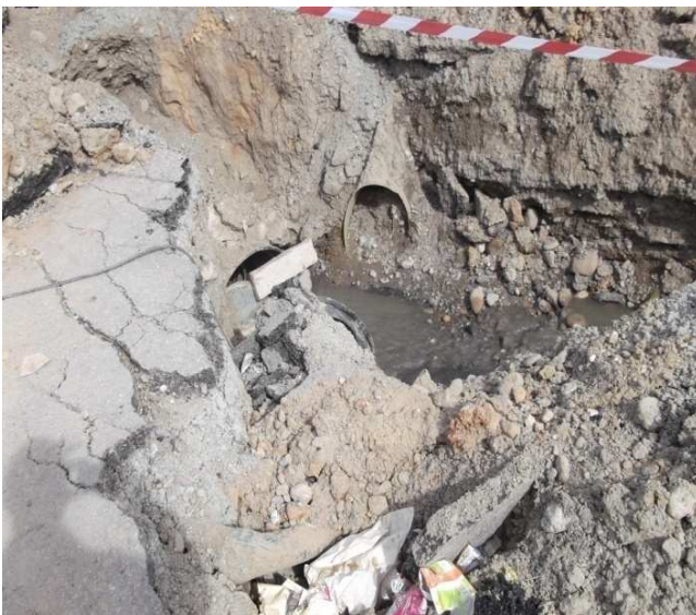
Réseau d'assainissement non raccordé
