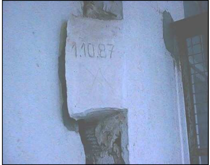
Dislocation du joint et rejet de 10 à 15 cm [11]
