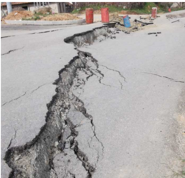
Affaissement de la chaussée
