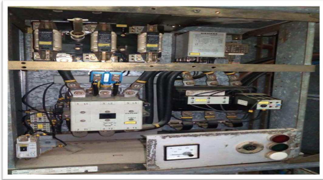
Figure II.3: Armoire électrique d'une pompe à incendie.
