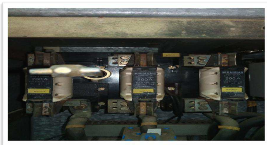
Figure II.4: Sectionneur porte fusible.
