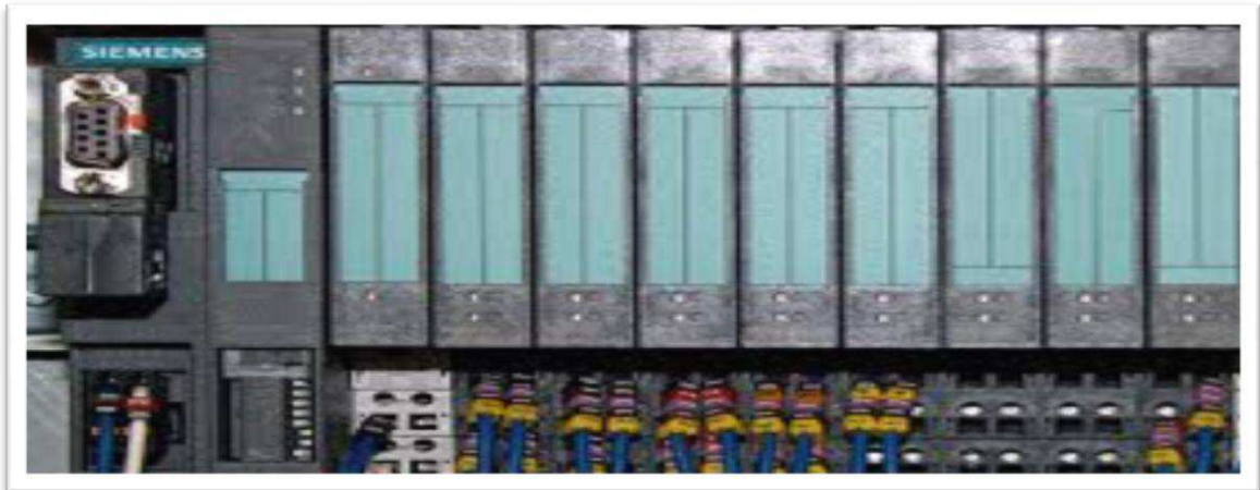
Figure II.3: Vue générale de l'automate S7-300.
