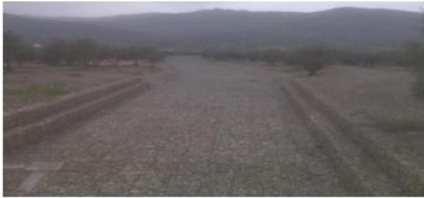
Figure 3.2 : Canal en matelas Reno au fond et sur les berges.(RABET et BEN HAMOU ,2018)
