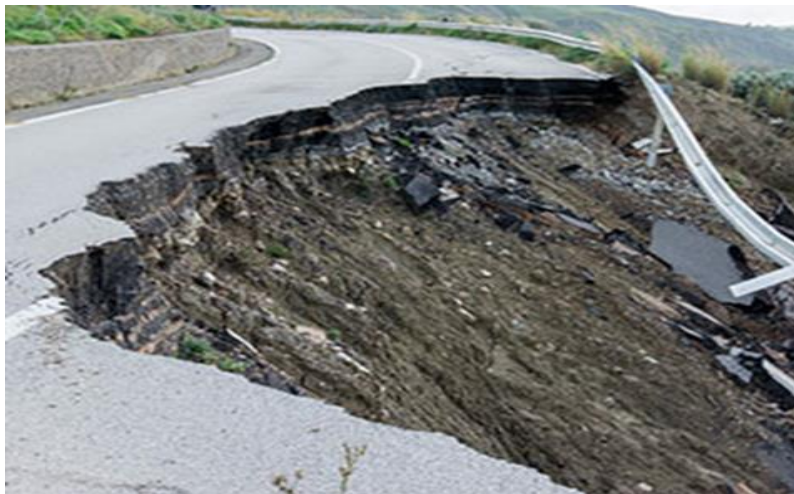
Figure I.8 : Exemple de rupture rotationnel sans fissuration
