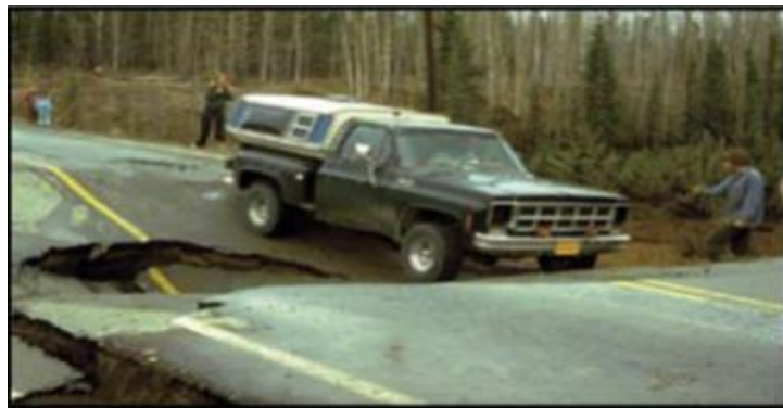
Figure I.6 : Exemple de rupture par poinçonnements du remblai sur sol compressible
