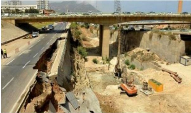
Figure I.9 : Rupture rotationnel avec fissuration
