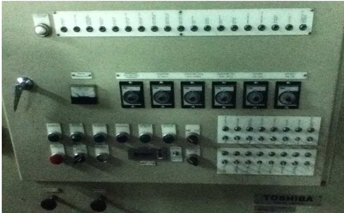
Figure II.6 : Image photographique du tableau de commande.
