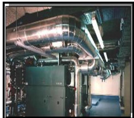
Figure 145 : groupe de production pour climatisation
