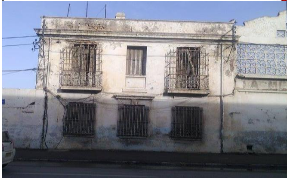
Figure57 : bâtis en état dégradé sur la rue Fernan Hanafi
