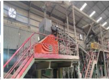
Broyeur à cylindres
