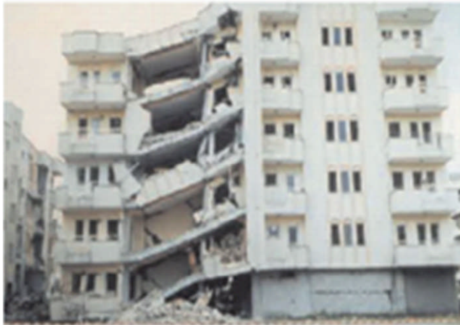
b) Effondrement partiel du rez-de-chaussée d'un immeuble d'habitation. L'effondrement total a été empêché par la présence du mur en blocs de béton (séisme de Ceyhan-Misis, Turquie, 27.6.1998).
