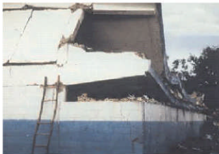
a) Effondrement de poutres en console (séisme de Cariaco, Vénézuéla, 9.7.1997) [6].
