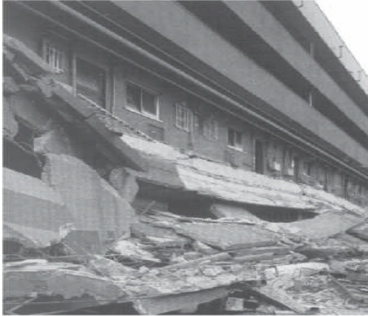
b) Effondrement de cursive en porte-à-faux (séisme de kobé-japon-1995) [6].
