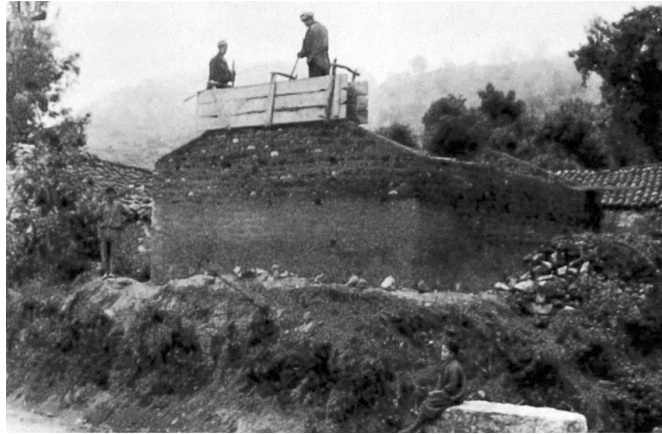
Figure 24 : Village d'Aït-Larbaa : construction d'une maison en pisé banché. Le maçon et son aide sont en train de tasser la terre des dernières assises du pignon.
