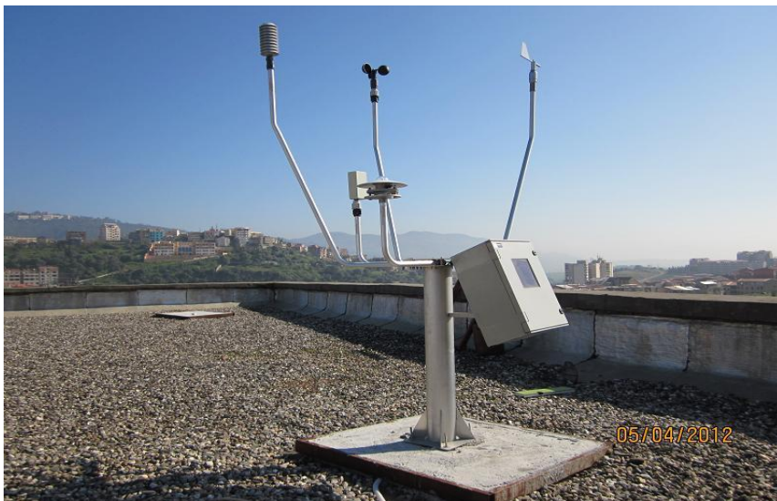
Figure I.13. Vue de la station automatique installée sur le toit du laboratoire LAMPA.
