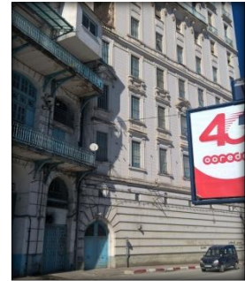
Figure 23: Etat de façade de la rue Bouchebai Youcef
