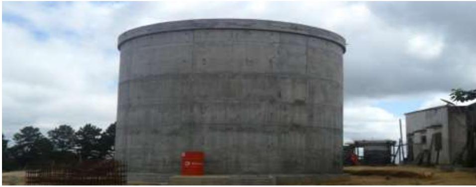
Figure 3.1: Réservoir posé au sol
