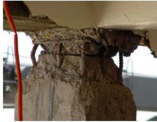
b- Destruction de l'extrémité du poteau.
