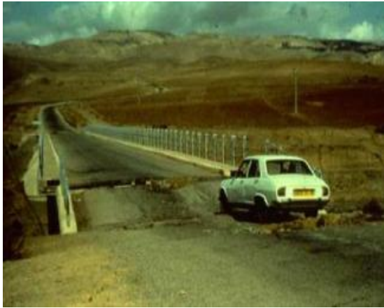
Figure 2. 7 Déplacement transversal du tablier et destruction des butées d'un pont (séisme d'El Asnam « Algérie » 1980). [53]
