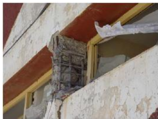
d- Destruction par cisaillement du poteau court
