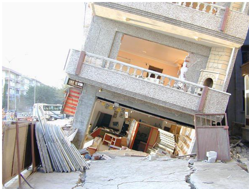
Figure 2.15 Poinçonnement de la fondation suite à la liquéfaction du sol. Séisme de Kocaeli en Turquie [62]
