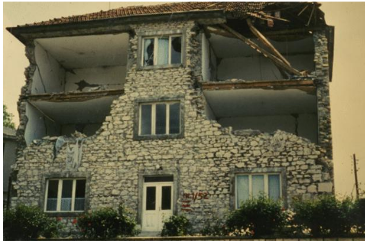
Figure 2. 4 Bâtiment en maçonnerie en pierres brutes, endommagé lors du séisme de 1979 au Monténégro, Yougoslavie. [46]
