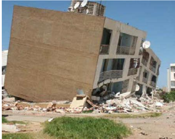
Figure 2.13 Effondrement complet d'une construction au niveau 1 Séisme de Boumerdes 2003, Algérie. [58]
