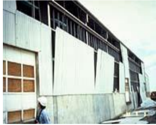
Figure 2. 6 Détachement du bardage de façade (Séisme Coalinga Californie, 1983). [48]
