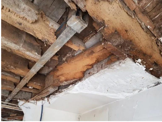
Figure 2.5 Poutres en bois endommagées, révélant la dégradation des matériaux. [50]
