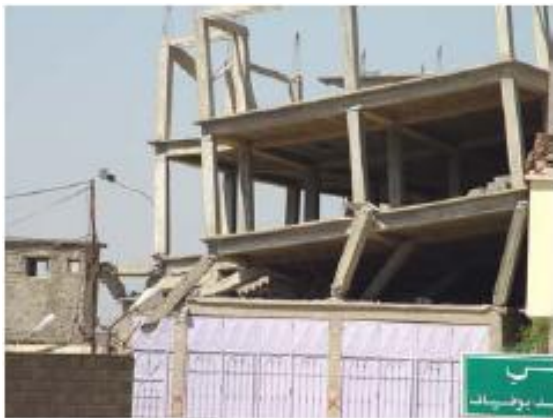
a- Cisaillement des poteaux de l'étage intermédiaire.
