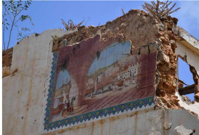
Figure 2. 3 Dommages sur un bâtiment en maçonnerie dans la Casbah d'Alger après un séisme [45]
