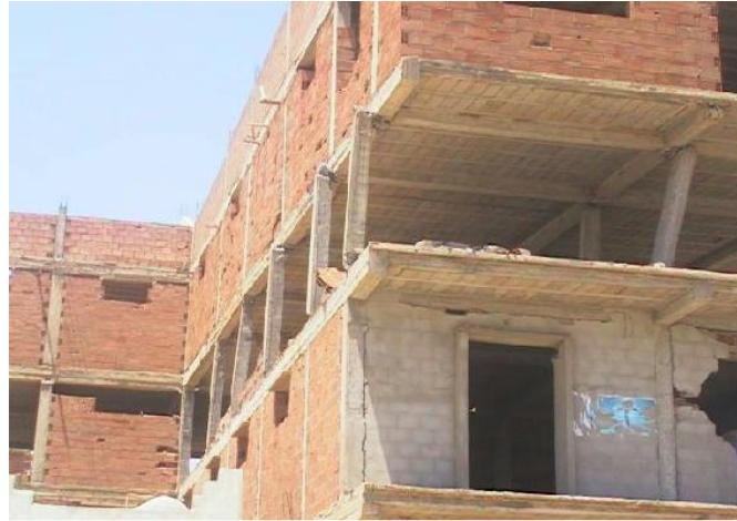
Figure 2. 10 Cisaillement des poteaux d'une construction à Bordj el bahri. Séisme de 2003, Boumerdes, Algérie [46]
