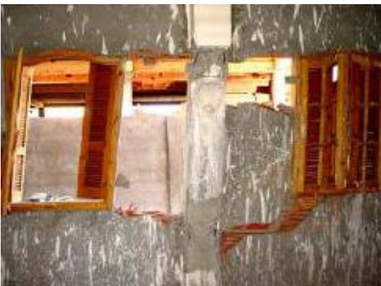
c- Poteaux courts en raison de la construction adjacente
