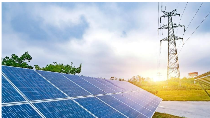
Figure 85 : Panneaux photovoltaïques connectés au réseau Source: www.energreen.be
