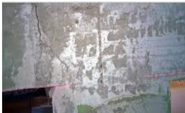
Figure I-13 Fissuration par cisaillement dans la poutre.
