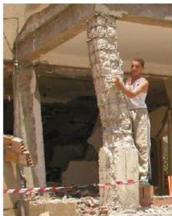
Figure I-9 : Qualité de béton est mauvaise [2].
