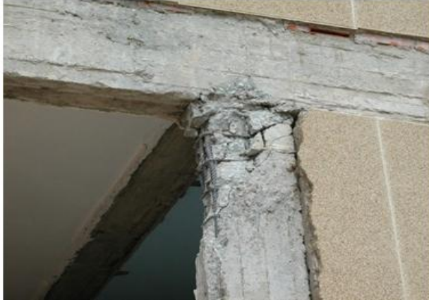
Figure I-15 Rotule dans le poteau (comportement à éviter) [1]
