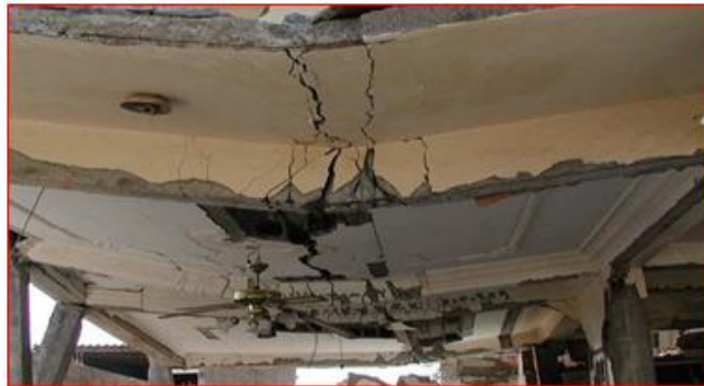
Figure I-12. Fissuration par flexion dans la travée des poutres, (Séisme de BOUMERDES, Algérie 2003)[24].
