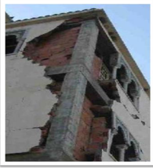
Figure I-6 : Dommages sur les éléments non structuraux [2].
