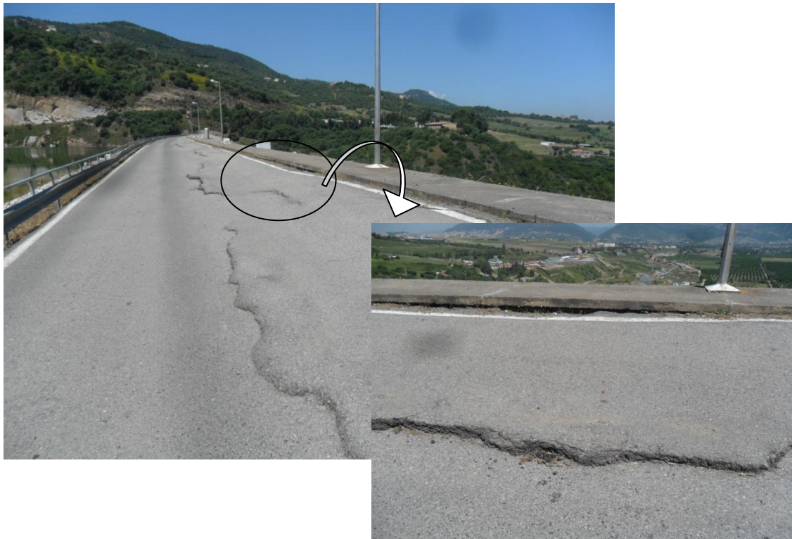
Figure VI-4: Tassement de la revanche du barrage
