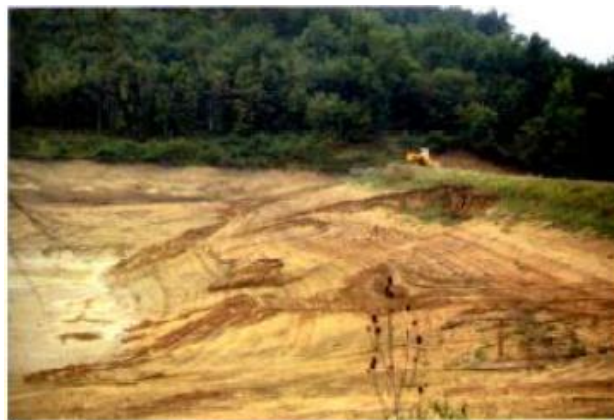
Figure II-2 : Le glissement du talus , Barrages d'ARMUS et CAU ; (GERS ,France)
