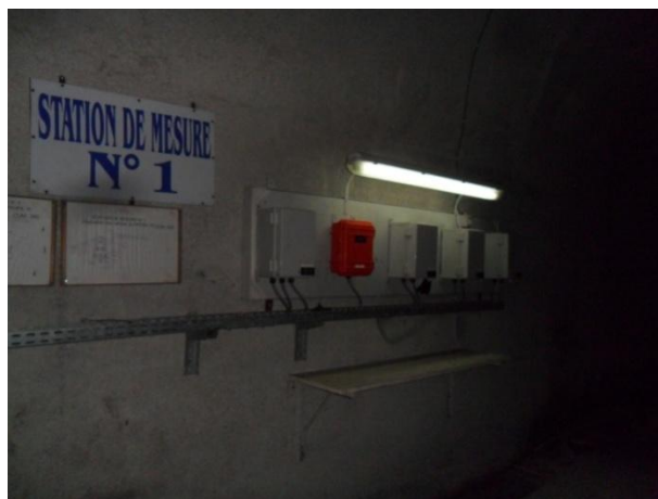
Figure VI-6 : Station de mesure N° 1
