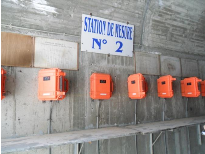
Figure VI-7: Station de mesure N° 2
