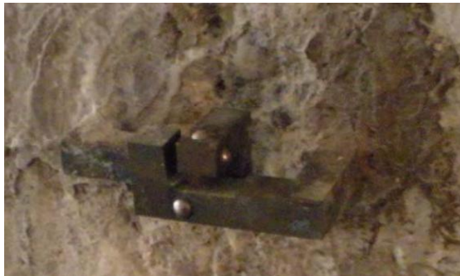
Figure IV-7 : Vinchon mesurant l'écartement d'une fissure
