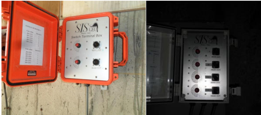
Figure VI-9 : Boites répartiteurs des câbles des cellules
