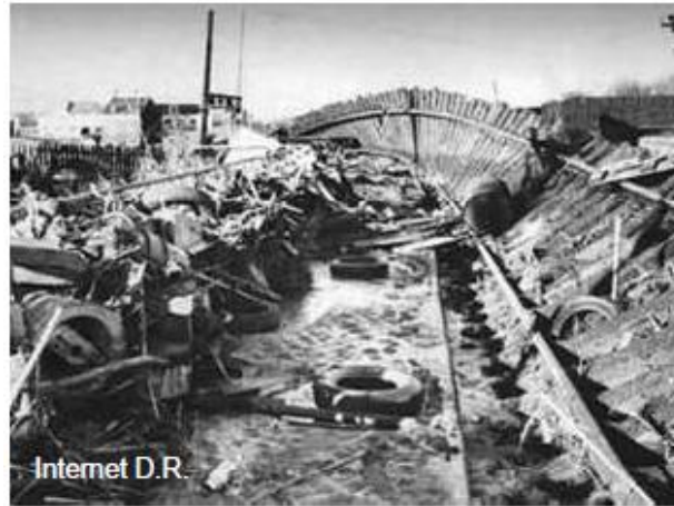
Figure II-7: La voie ferrée « vrillée comme un jouet »
