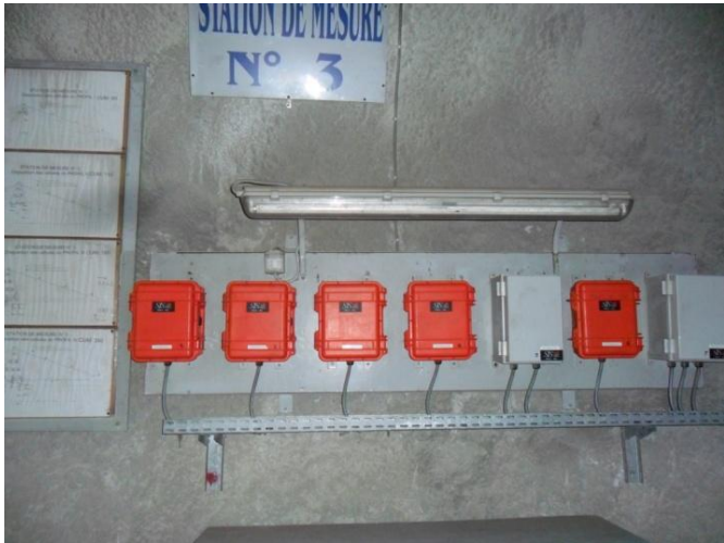
Figure VI-8: Station de mesure N° 3
