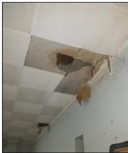
Photo II-13 : Vue sur le plancher dégradé de l'amphi Source : Auteurs, prise le 05/03/2019
