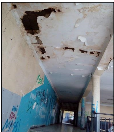
Photo II-12 : Vue sur le plancher dégradé Source : Auteurs, prise le 23/04/2019
