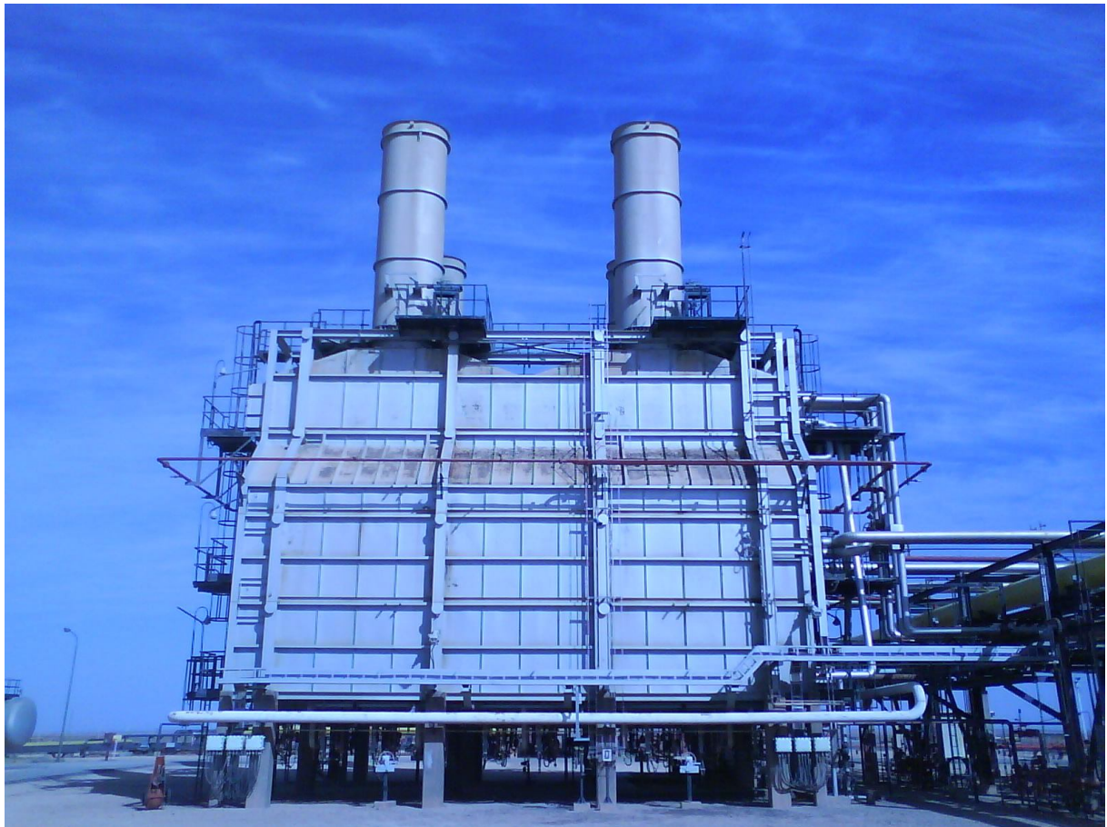
Figure I.4 : Le rebouilleur H101.
