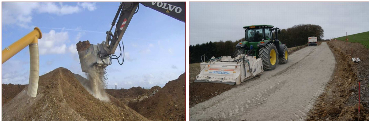
Figure I.3 : malaxage de sol avec le ciment et mise en œuvre de sol ciment
